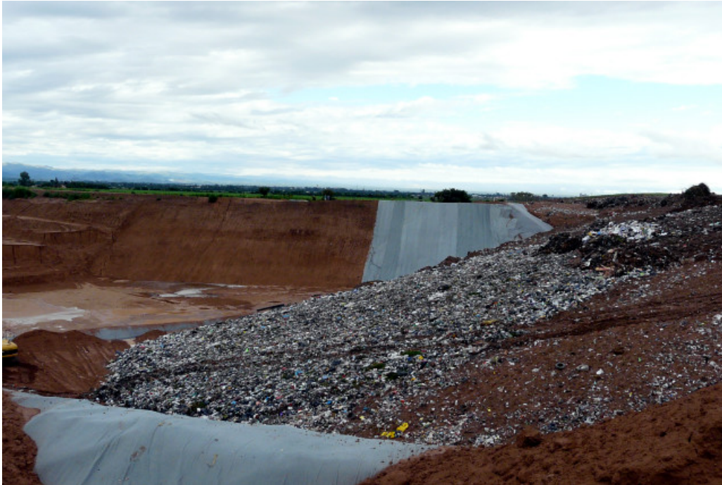
Imagen n° 1. El talud norte de esta celda aparenta tener una pendiente más pronunciada que la recomendable.
