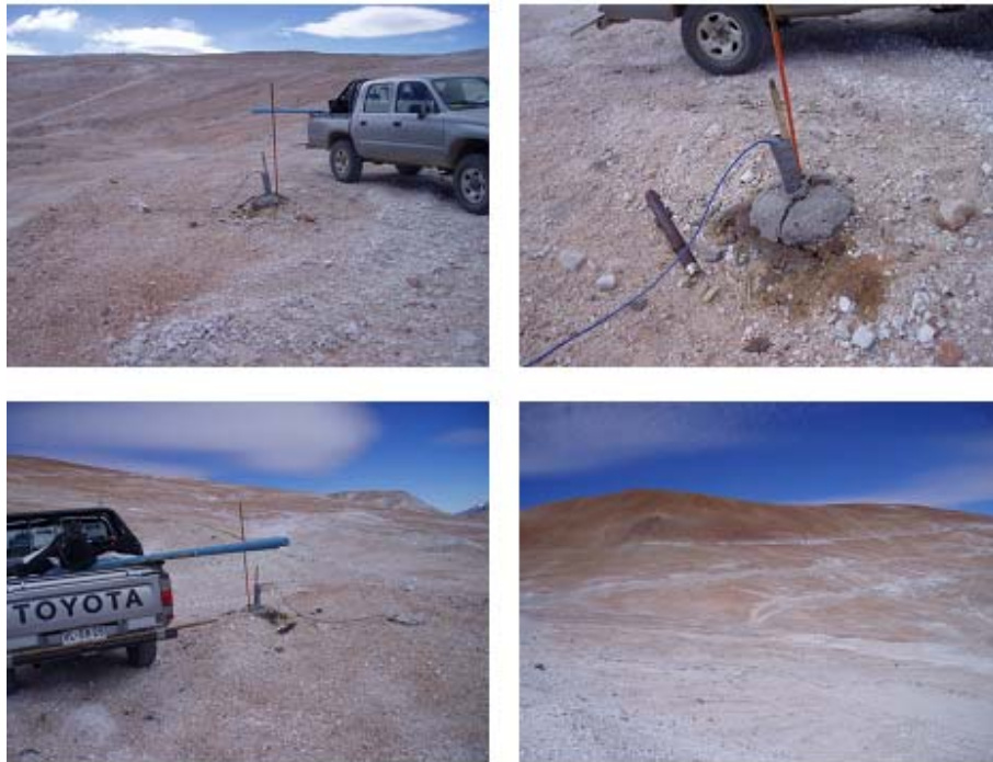
Fotografías 3. Sitio de emplazamiento e instalación del Termistor 100.1 Pascua. Fuente: BGC. 2011
