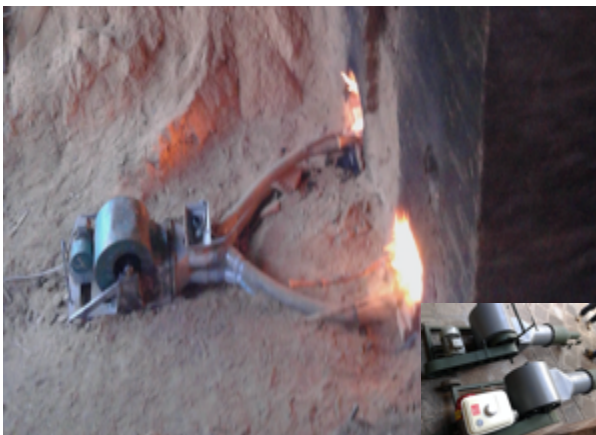
Adaptar un aireador a la combustión baja el gasto en combustible y mejora la eficiencia de la quema
